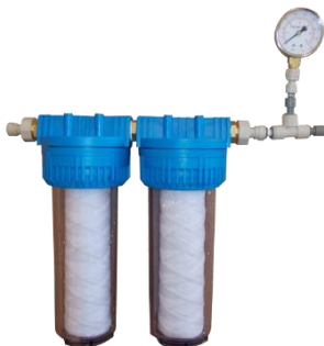
Figura 4. Filtro na tubulação de acesso à água.
